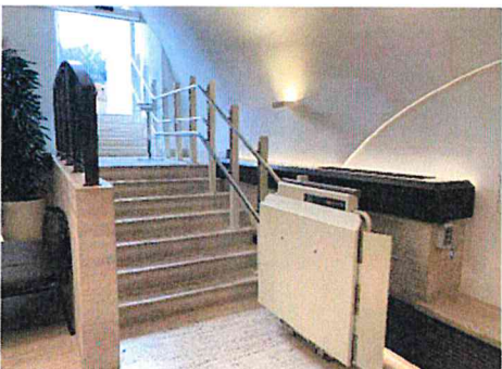
2. Servoscala ingresso Piano Seminterrato
